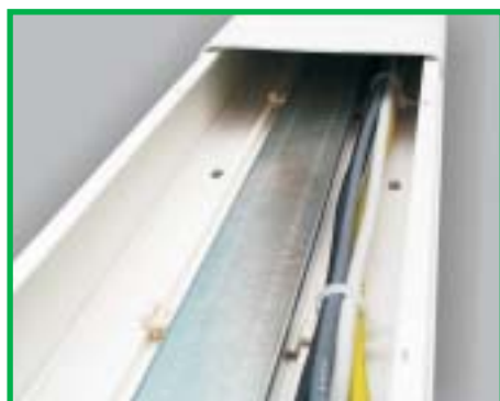
EKE csatorna a behelyezett árnyékoló csatornával és a PSK 1 kapcsolókkal.
